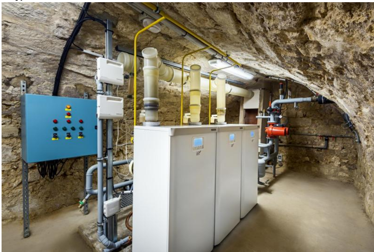
Экономичная каскадная котельная во французском замке Loureigne
