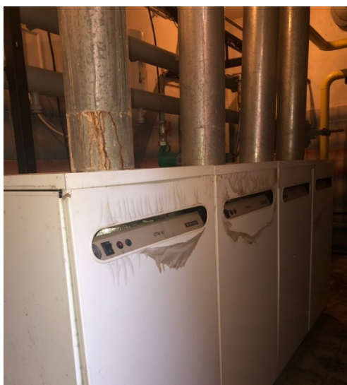
Котельная из четырех модулей UTM-50 начала 21-й отопительный сезон.
